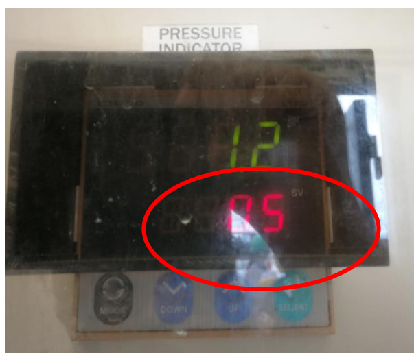
รูปที่ 2 หน้าจอแสดงผลการตรวจวัดความดัน (Pressure Indicator) บริเวณสถานีตรวจวัดคุณภาพน้ำแบบต่อเนื่องบริเวณคลองระบายน้ำหล่อเย็นของโครงการ
