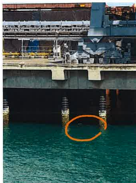
รูปที่ 2 รอยรั่วซึมบริเวณท่าเทียบเรือขนถ่ายถ่านหินของโครงการ
