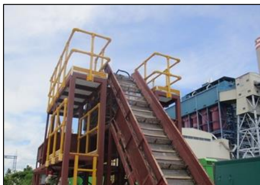
รูปที่ 2 อุปกรณ์ Mesh Belt conveyor บริเวณคลองส่งน้ำหล่อเย็น
